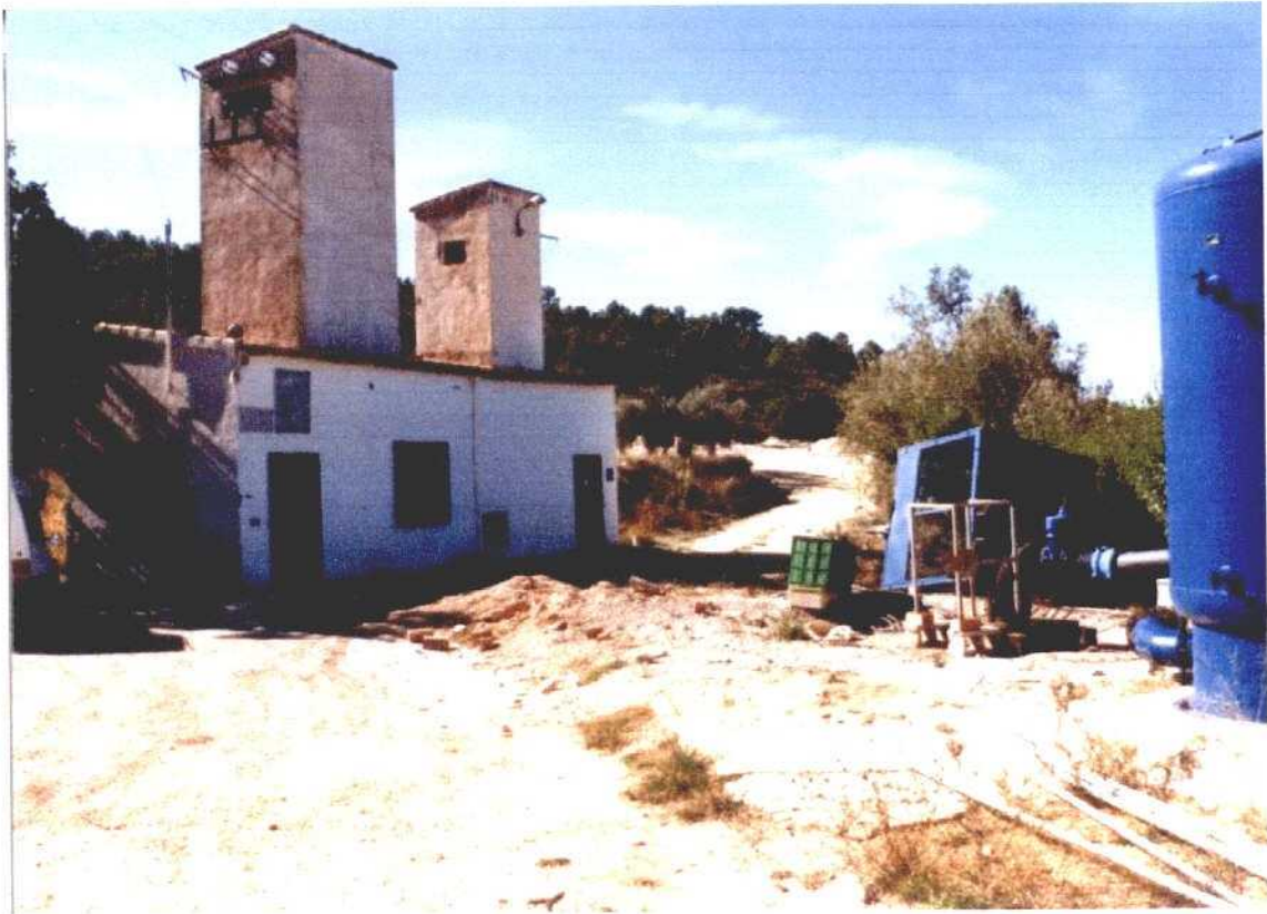
Punto acuífero n° 283340019. Pozo n° 5 – Pla de Campaneta.
