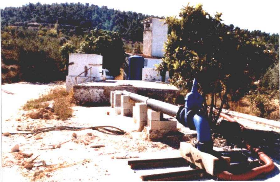
Punto acuífero n° 283340020. Pozo n° 4 – Pla de Campaneta.
